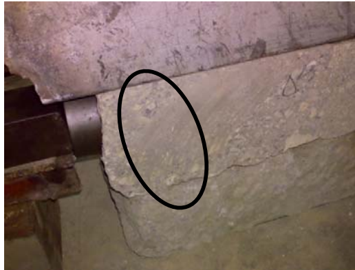
Gambar 3. Retakan pada pasangan batu candi tanpa pengisi tanah
