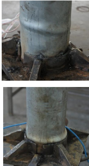
Gambar 3. Pola runtuh kolom K2-A dan K3-A
